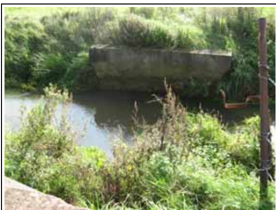
Alte Brückenfundamente an der Düpenau. Die offenbar ehemals bestehende Verbindung „Im Düpen“ ↔ „In den Düpen“ sollte wieder hergestellt werden.
